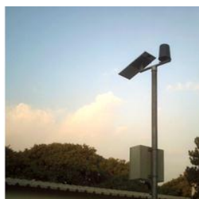
Placa Solar do Pluviômetro Digital SAISP Foto dos Autores
