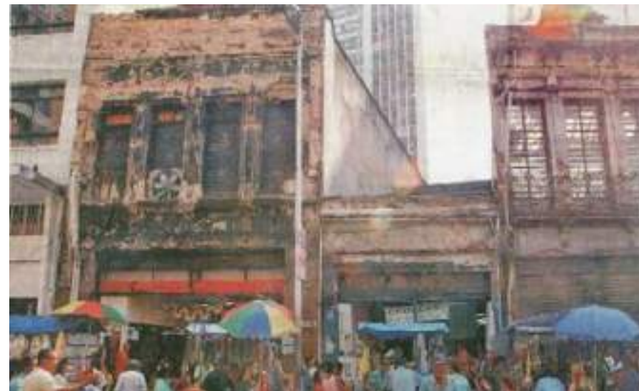
FIGURA 14: Características arquitetônicas descobertas sob anúncios na implantação da LCL
